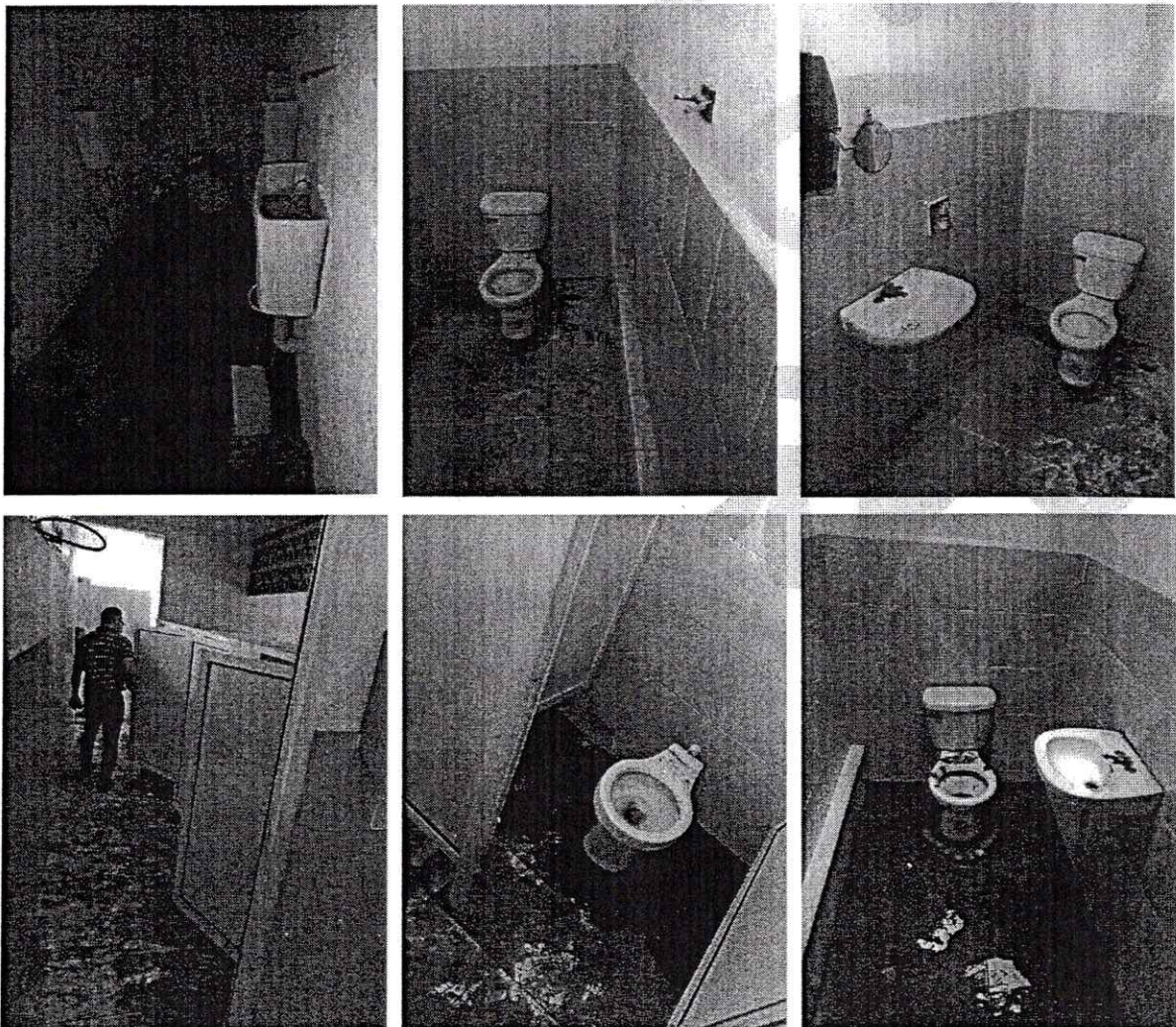
Situación actual de los sanitarios en malas condiciones.
